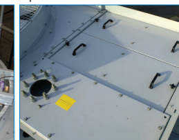
Coperchi vasche di distribuzione*
