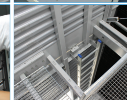
Piattaforme di manutenzione interne*
