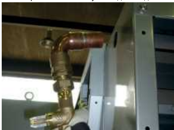
Подсоединение подачи воды
