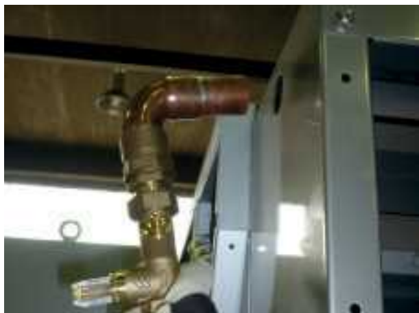
Узел подачи воды
